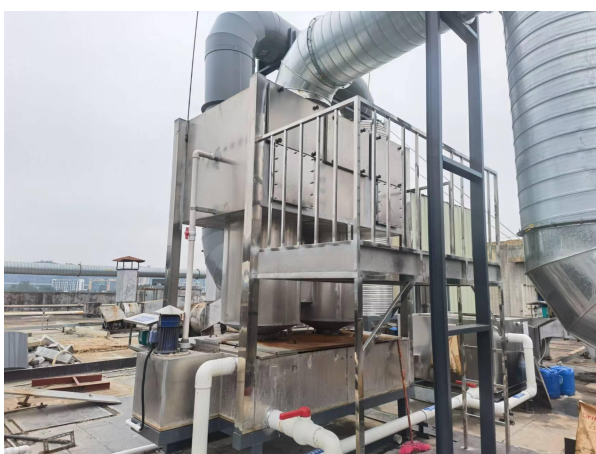
面漆旋流喷淋塔2
