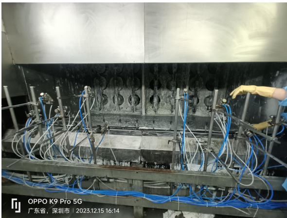
喷漆车间面漆喷漆房
