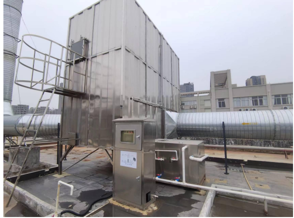
底中面合并后废气净化除臭塔
