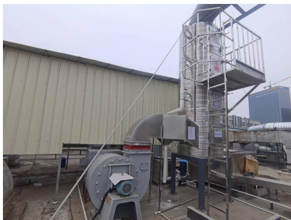
面漆旋流喷淋塔1
