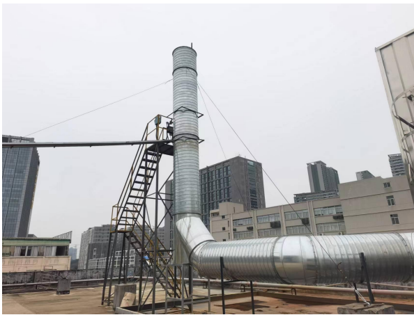
DA002合并后排放管道
