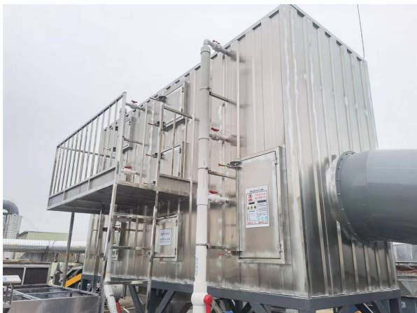
四级旋流六级喷淋洗涤吸收塔
