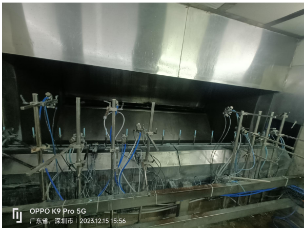
喷漆车间底漆喷漆房
