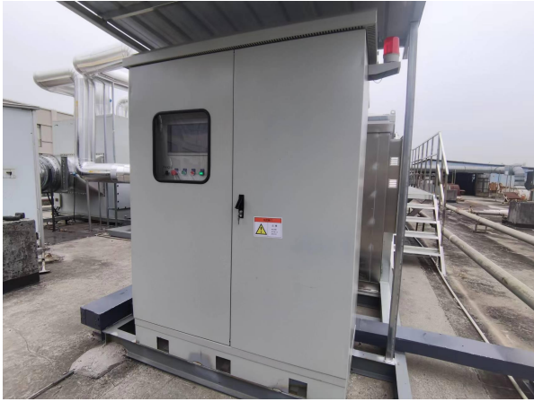
面漆废气净化系统控制电柜
