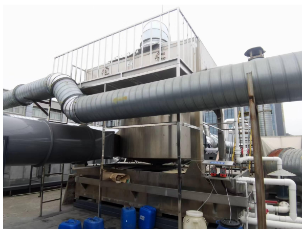
方形喷淋吸收塔
