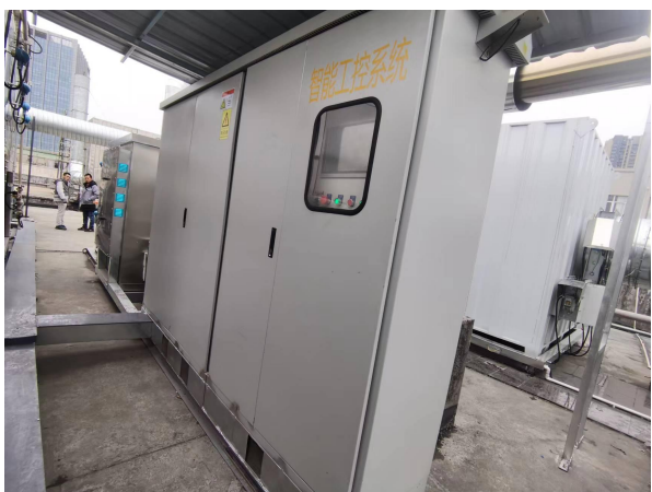
沸石转轮吸附浓度+催化燃烧系统控制柜
